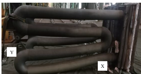
图7 辐射管变形开裂图
