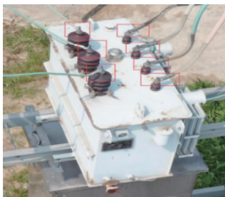
图 1 10 kV 柱上变压器现场采集图
